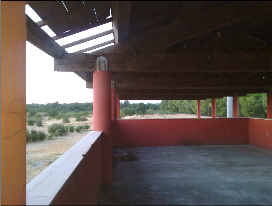
Foto 7 – copertura divelta del terrazzo
